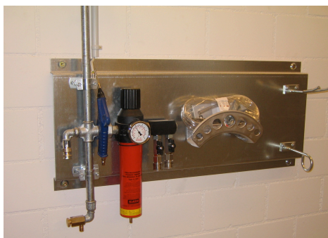
DL-Wartungsstation mit Magnetventil stromlos geschlossen, nach SUVA
