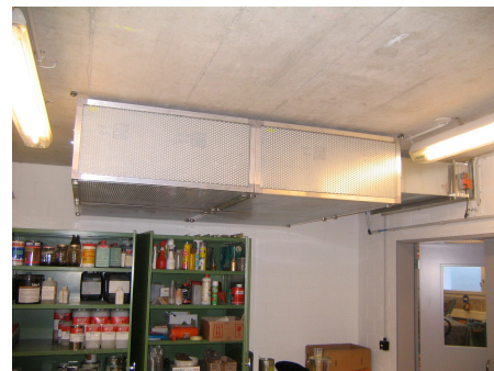
Zulufthaube mit Filter für staub- und zugfreie Nachströmluft im Spritzraum
