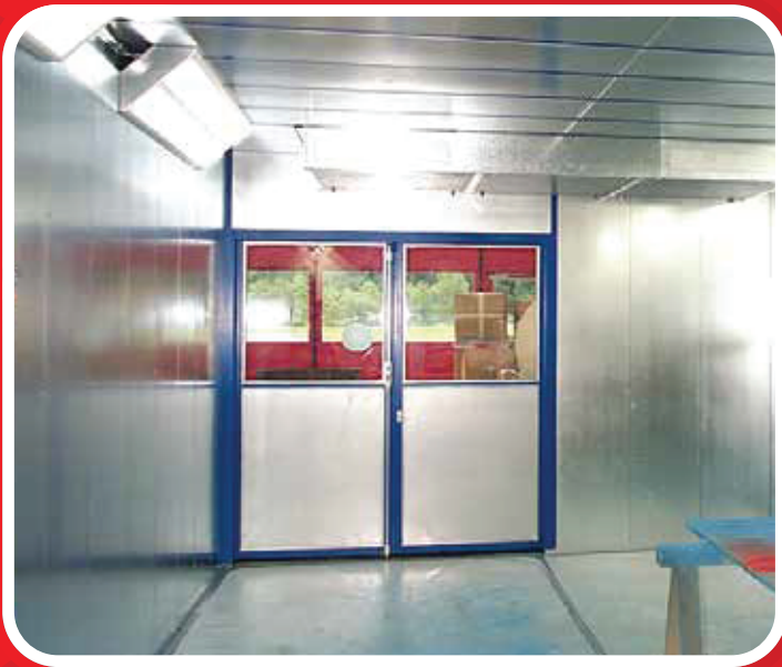
SAW KVH BTK Tor, Zuluft und Ex-LED Beleuchtung
